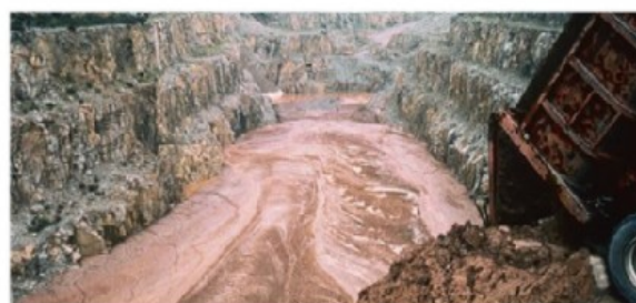
➤ Stockage de déchets de traitement de minerai (résidus) dans l'ancienne mine à ciel ouvert de Bellezane
